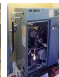
▲エアコンプレッサー オイルの量・汚れの確認。圧縮時の異音、エア漏れ、ドレンの有無など
