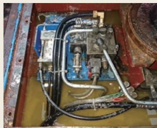
冠水被害で泥水が溜まってしまった埋設式2柱リフト
