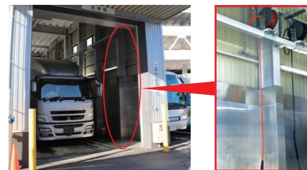
洗車時、汚れを清掃しやすいように壁面をステンレス仕様に。 洗車ホースを吊り下げ式にして劣化を防止
