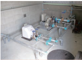
工場内地下に30tタンクを埋設し、雨水を洗車や散水・トイレの洗浄水として再利用するシステムを導入
