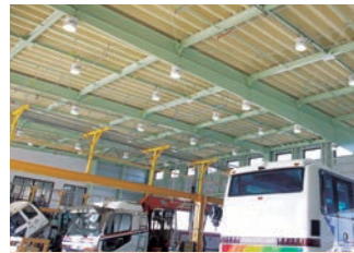
天井には96個のLEDライトを設置。レーン毎の消灯が可能で、ムダな消費電力をカット
