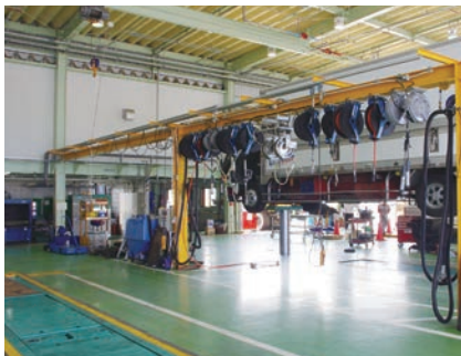
海外で見た架台を参考に、改良を加え製作した床上アーチ式の集中給油システム。フロアーの左右でメカニックが作業できるよう3ヶ所に設置
