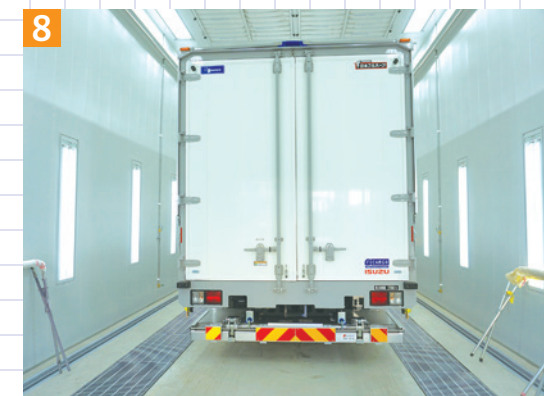
▲高さ約 5.9m、奥行き約 16m。大型車の塗装作業に完全対応
