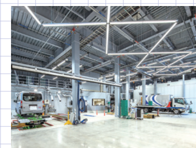
▲天井が高く、解放感のある1階中2階にコンプレッサを設置
