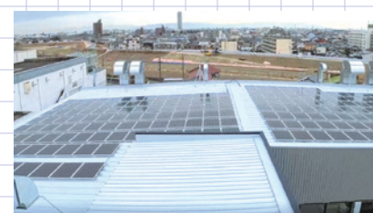
▲屋根には太陽光パネルを敷設。環境保全の面でも大きなメリットがある太陽光エネルギーを使用
