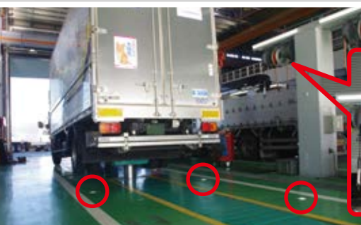
▲“ツインパワーリフト”には下部照明を敷設。自立式リール架台にもLED照明が設置されている為、上部・下部から手元を明るく照射
