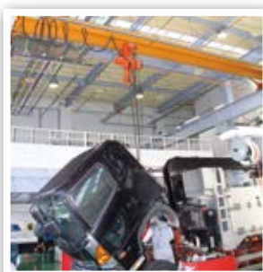
▲エンジンやミッション脱着に加え、トラクター上板の取り外しなどに活用されている天井走行クレーン
