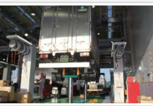
▲2柱式“ツインパワーリフト”を縦列で2基設置し、1ストールを有効活用
