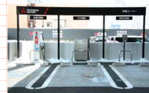
◀お客様用駐車場には電気自動車用の急速充電器やV2H機器が設置
