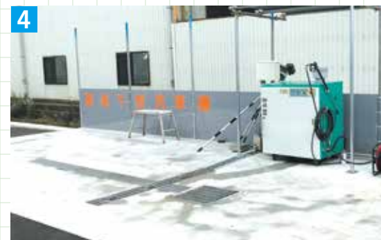
▲洗車場には、車両の下回りを洗浄するための“下部洗浄装置”を設置。下回り塗装前に洗浄するこだわりのサービスをご提供
