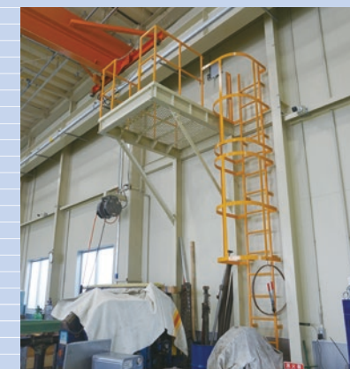
▲天井走行クレーンの点検台。安全性重視の保護柵付き
