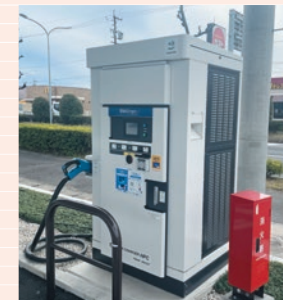
▲駐車スペースの一角にはEVの急速充電コーナーを設置
