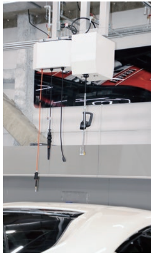
◀オイルリール（右側）をリフト2基ごとに1本配置し、オイル交換の作業効率を高めたつ床の汚れを防止。電動車対応も見据えて高電流（20A）の「コードリール」（右から2番目）も設備
