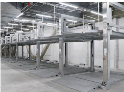
▲低床仕様立体駐車場を導入した車両置き場は整備ストールと区別すべく床を未塗装に
