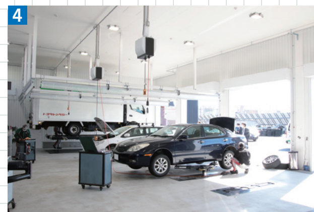
▲バリエーション豊富なリフト機器。“アルネオリフト”は耐水仕様やユニット別置きとし、メンテナンス性を重視
