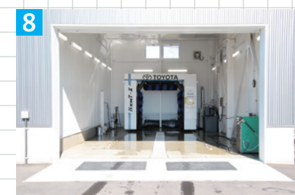
▲洗車ストールは床暖房を完備
