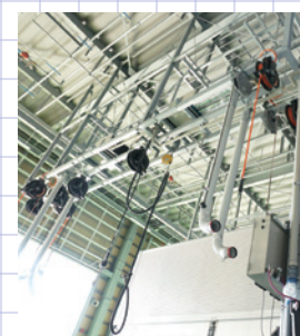
作業が行いやすいようリールの配置を決定。エアコンも全てのスToolに設備
