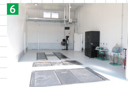
▲完成検査はシステム化によって効率化。4WD車用対応でフリーローラーの導入はマスト
