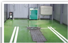
◀複合廃液集中吸引分別管理システム“FVシステム”。工場上部に巡らせた配管から廃液を吸引するため土壌を汚染する心配がなく、周辺環境へ配慮
