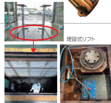
ヘドロ溜まり 水溜まり
