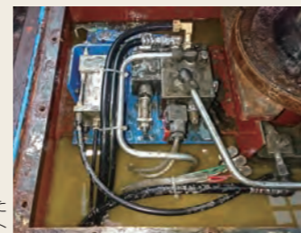
冠水被害で泥水が溜ってしまった埋設式2柱リフト
