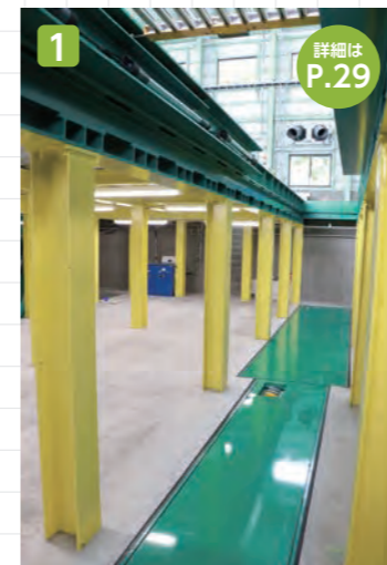
“2分割フロアリフト”は、2基の地下ピットをつなげ、収納兼作業スペースとして有効活用
