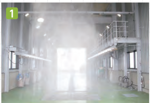
洗車場には上下に散水栓を設置し、作業効率化を実現
