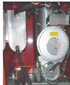
ステンレスボイラー、バーナー部
