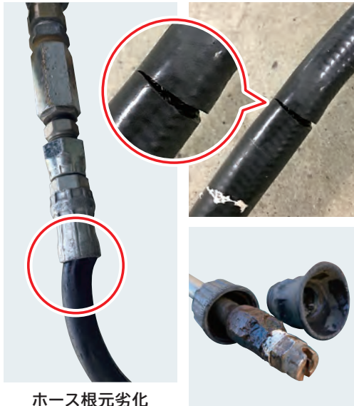
ホース根元劣化
