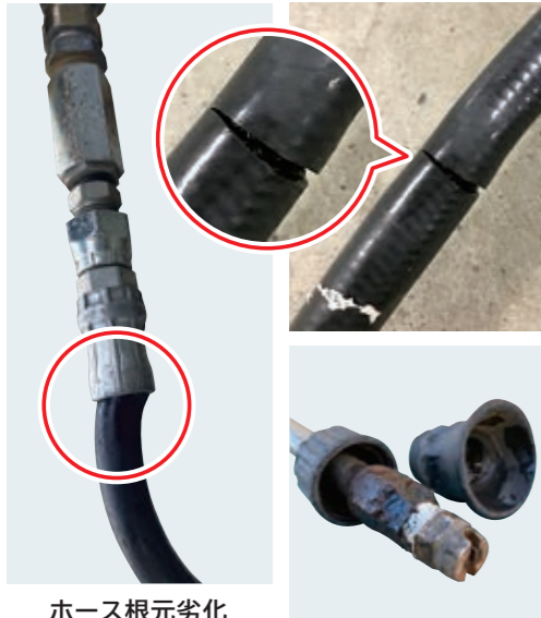
ホース根元劣化
