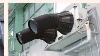
◀各ストールには空調を完備したほか出入口にシャッターを設け、冷暖房効率をアップ
